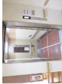
エレベーター
